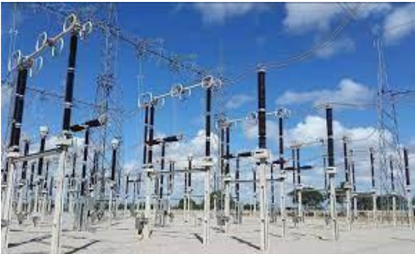
Figura 5- Subestação de energia elétrica. Fonte: https://blog.tecnogera.com.br/ (2021)
